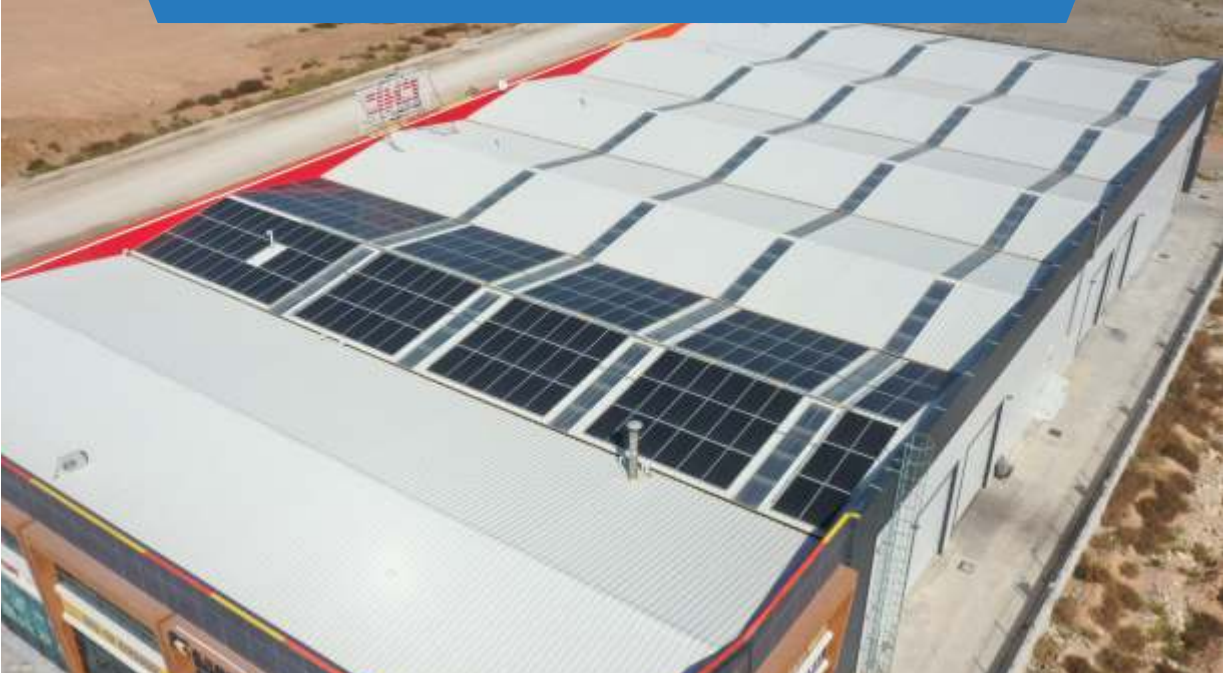
Apsan 2 | 70 kWp | KONYA - Karatay
