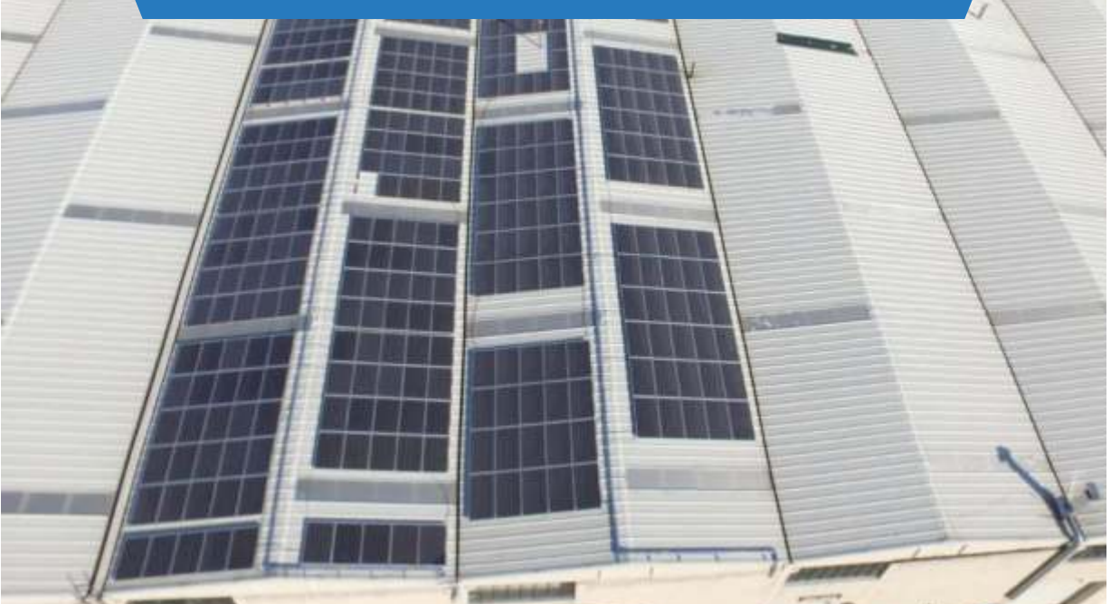
Mgh Elektrik | 60 kWp | KONYA - Karatay
