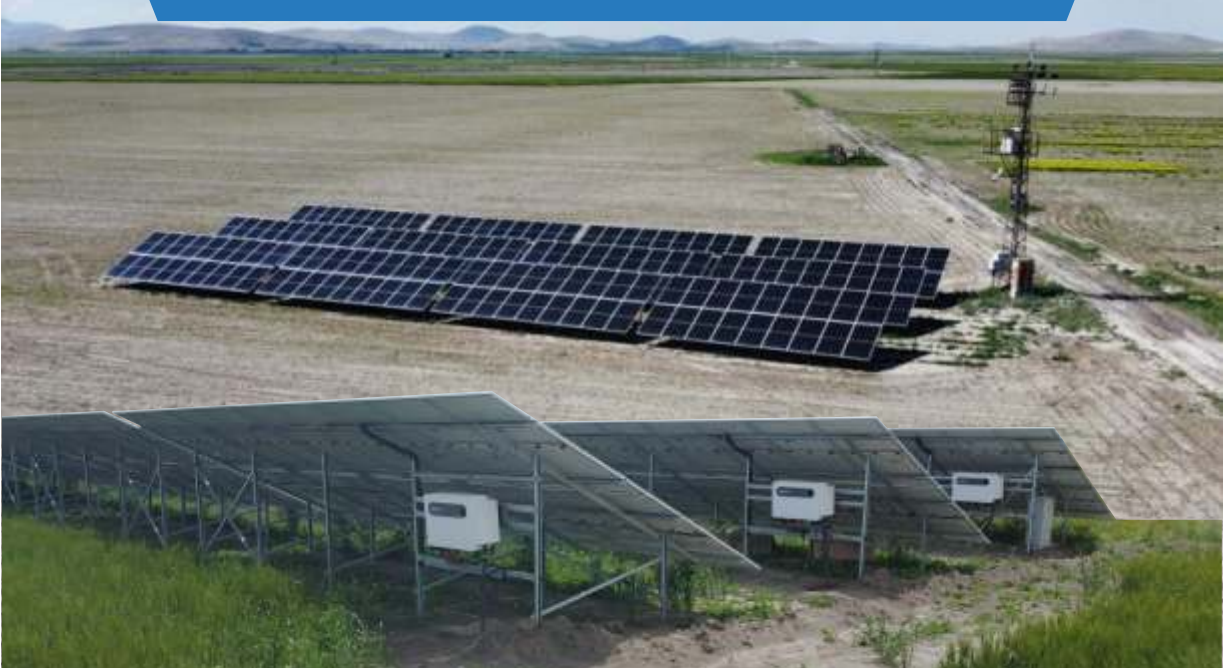
Necati Özgören / 118 kWp / KARAMAN - Osmaniye
