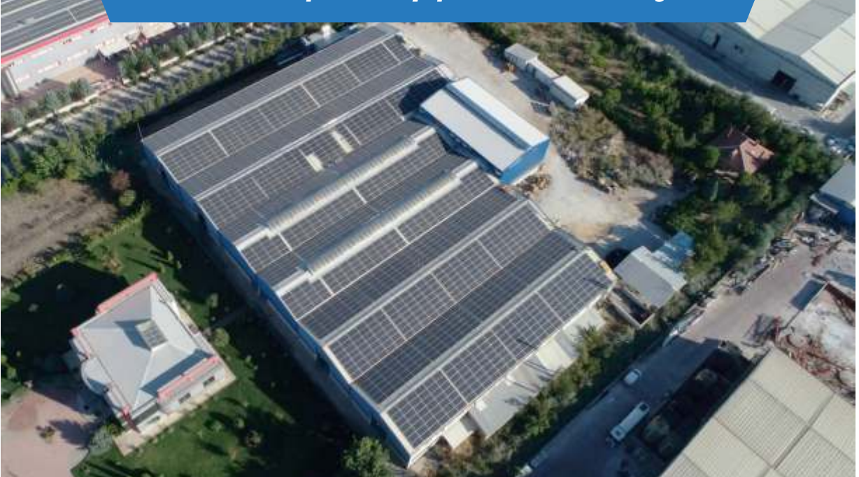
Arı Metal | 717 kWp | KONYA - Karatay
