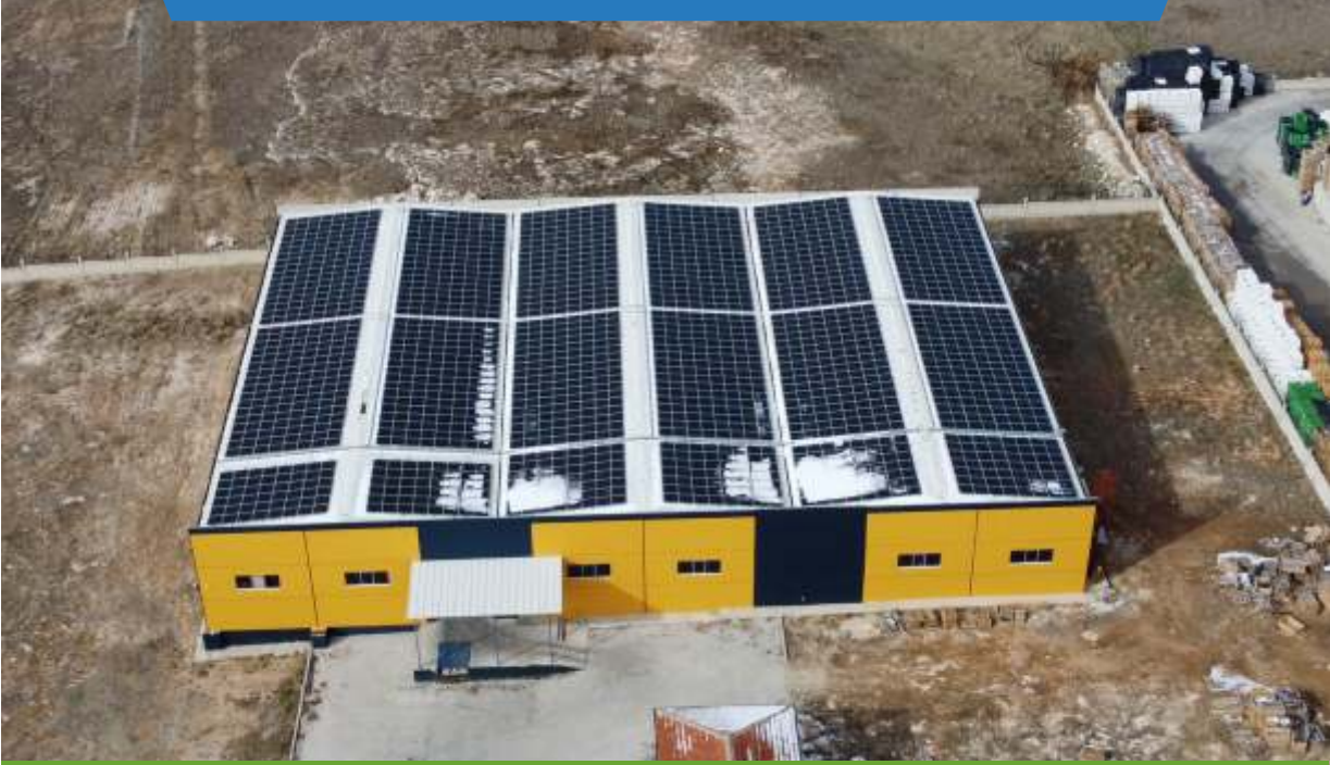
Som Ambalaj | 400 kWp | KARAMAN - Merkez
