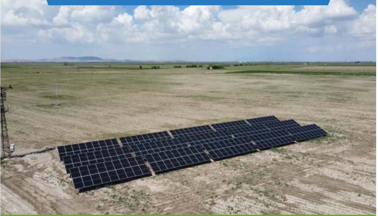
Necati Özgören / 123 kWp / KARAMAN - Osmaniye
